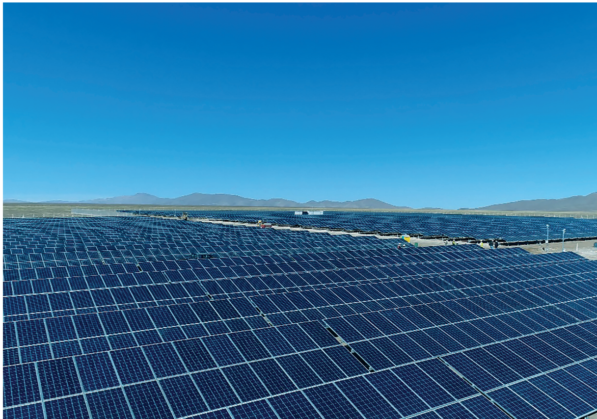
Planta Solar Fotovoltaica de Uyuni, departamento de Potosí. Fuente: www.ende.bo
