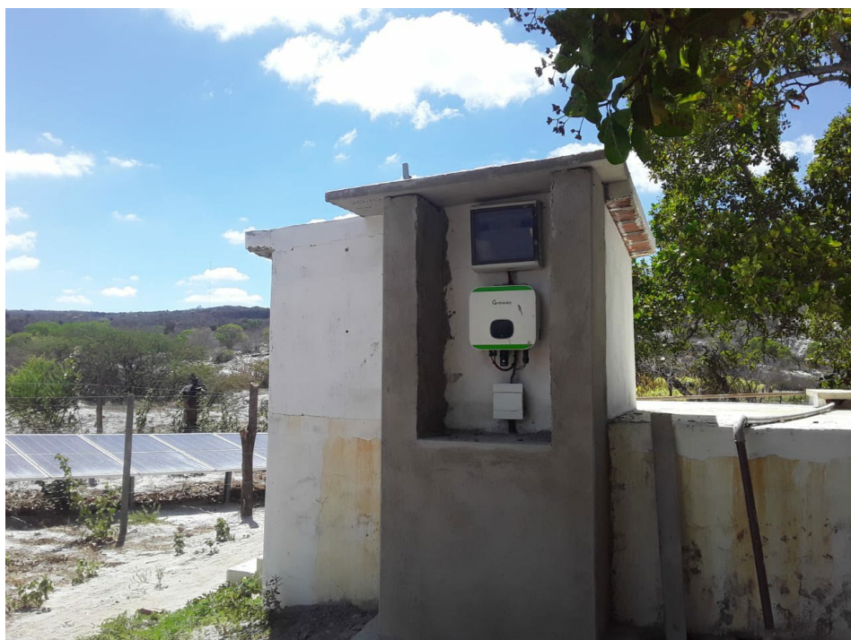
Placas fotovoltaicas na comunidade sitio Carneiro, municipio Junco do Seridó.
