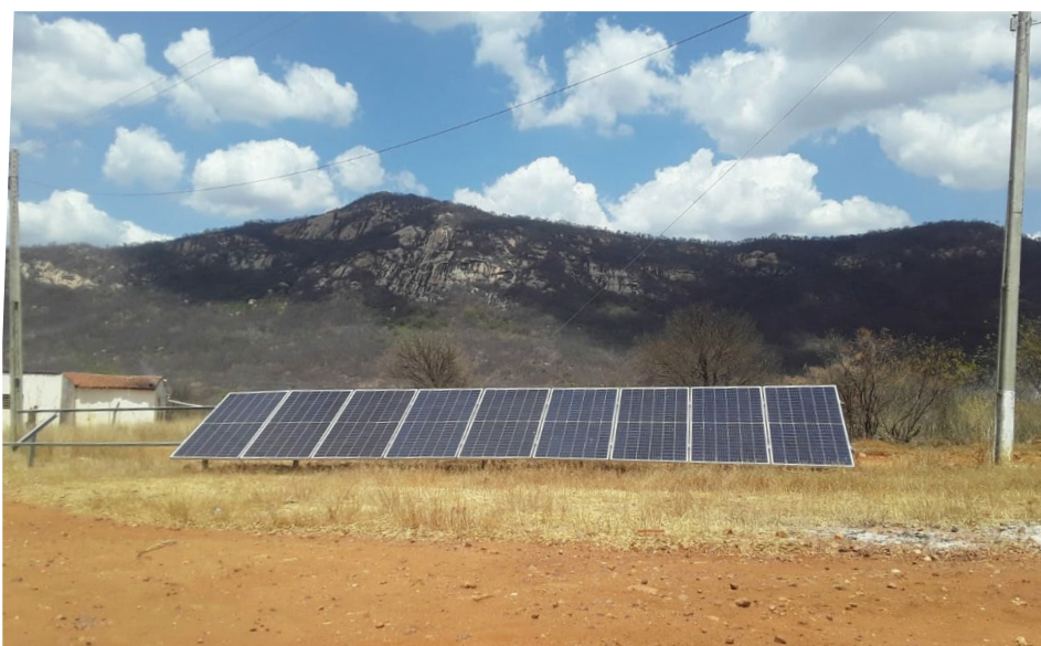
Placas fotovoltaicas no assentamento Padre Acácio, município de Malta.
