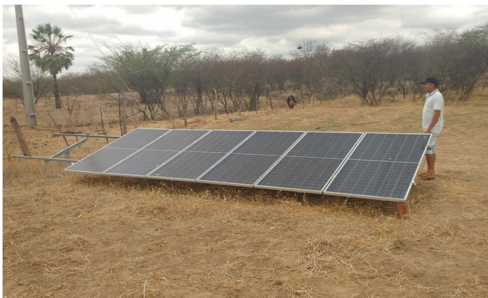
Placas fotovoltaicas no assentamento Novo Horizonte, município de Várzea.
