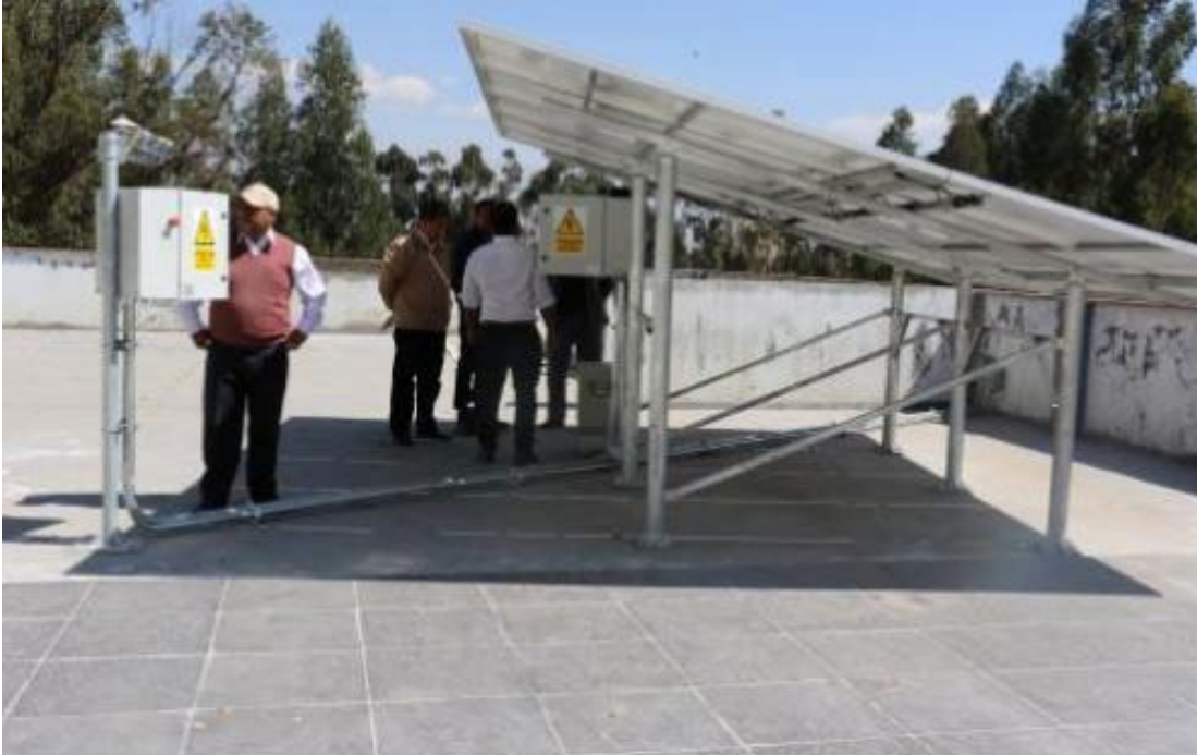
Imagen: Paneles solares instalados en la UNCP.
