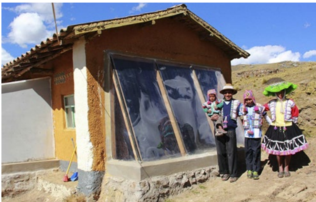
Imagen: Muro trombe instalado en casa rural.
